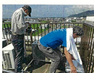
ビルの屋上への通信機器設置の様子
